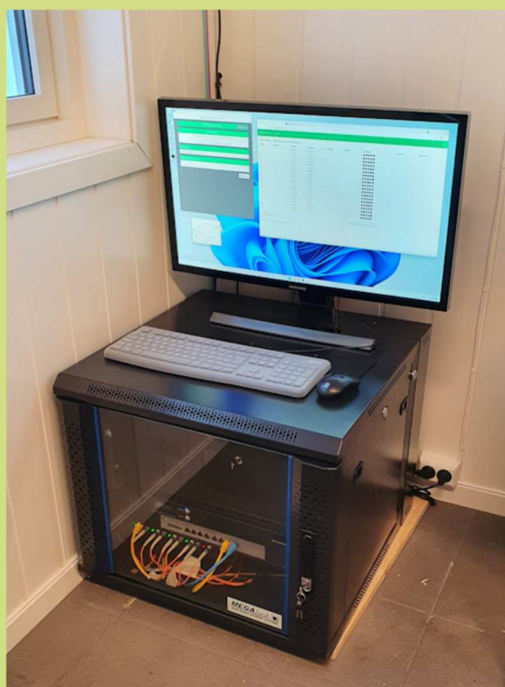
Kompakt enhet med server og UPS for kontinuerlig drift
